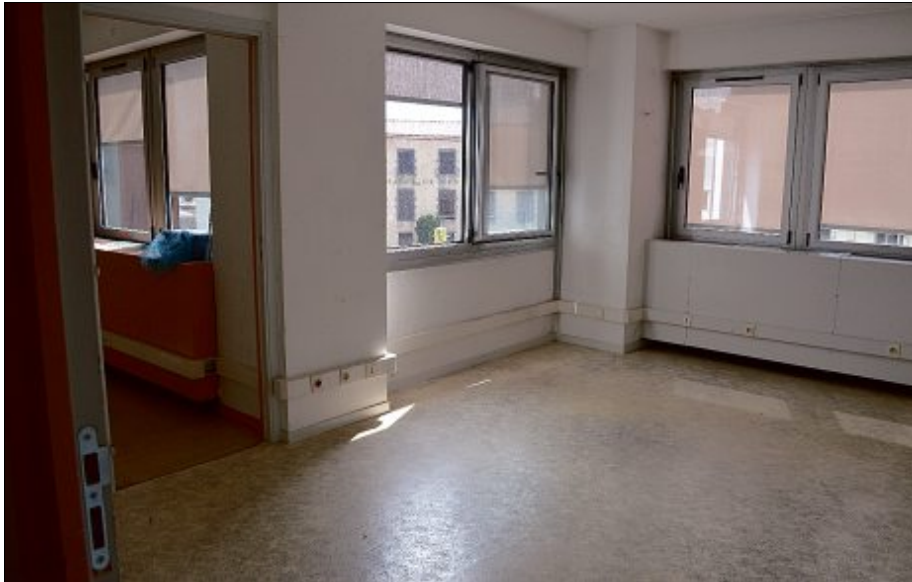
Depuis lundi 5 août, l'intégralité du deuxième étage du bâtiment de la mairie est vide, en attendant les premières interventions de désamiantage.
