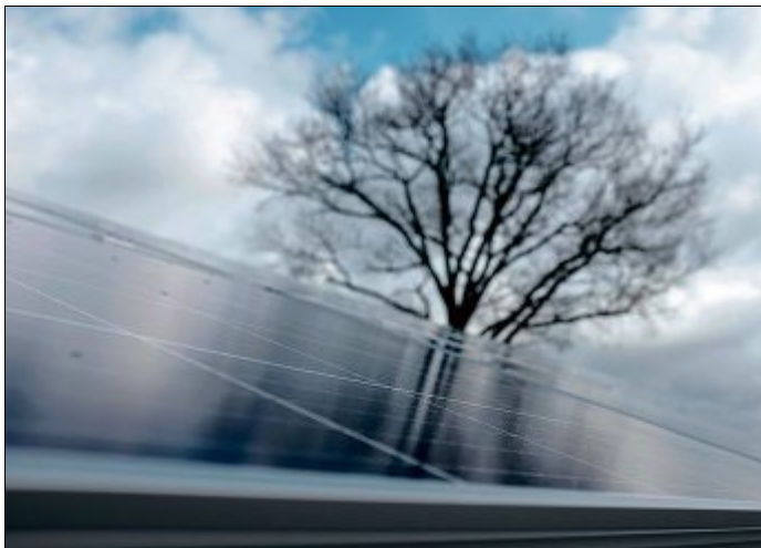
Sur les toits de l'église, c'est l'équivalent de la consommation en électricité de huit à dix foyers, hors chauffage, qui sera produite. (PHOTO D'ILLUSTRATION)
